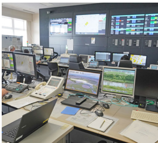
消防指令センターの中も見学させていただきました
