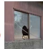
窓が割れた 管理不全空家
