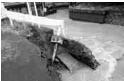
北星川の増水により削られた道路 (24線17号)
