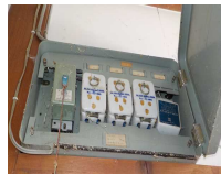
① 古い分電盤
